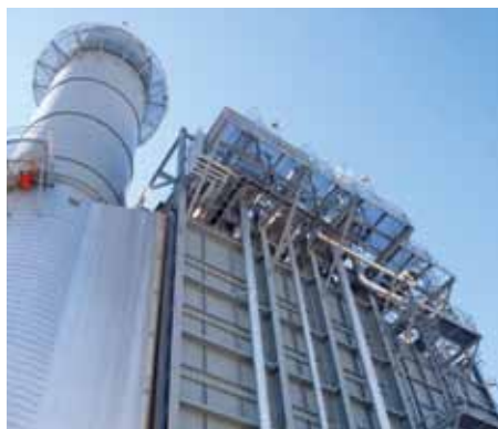
Все в одной компании: установка тканевых компенсаторов KE ® на газовых турбинах.
