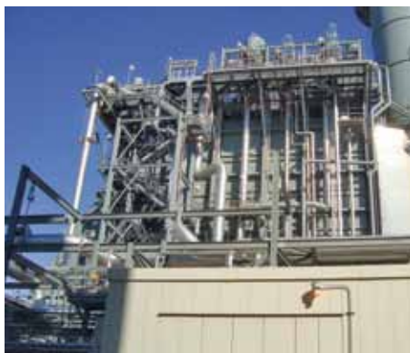
Установка тканевых компенсаторов KE® в газовых турбинах.
